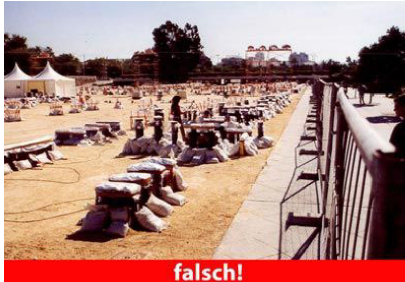
Abbildung 6: Absperrung mit zu geringem Abstand zu Passanten (während der Aufbauarbeiten)
